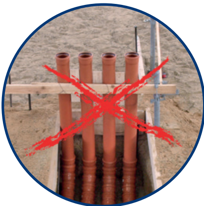
Nicht zugelassenes Leerrohr
